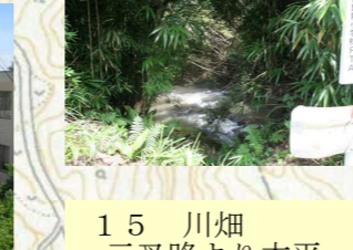
15 川畑 三叉路より本平へ 路肩が崩れ、その下 は急流がある。
