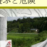
12 窪田 米丸踏切先橋と川淵 左手は柵も無く、落 下の危険あり
